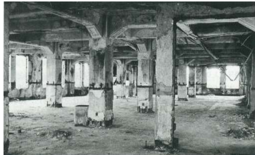
● 火災でがらんどうになった 中国配電(株)本店建物の内部(中国新聞社提供)
